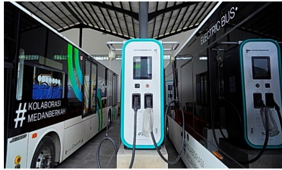
Gambar 2. 3 Stasiun Charging Bus Listrik BRT Trans Medan
