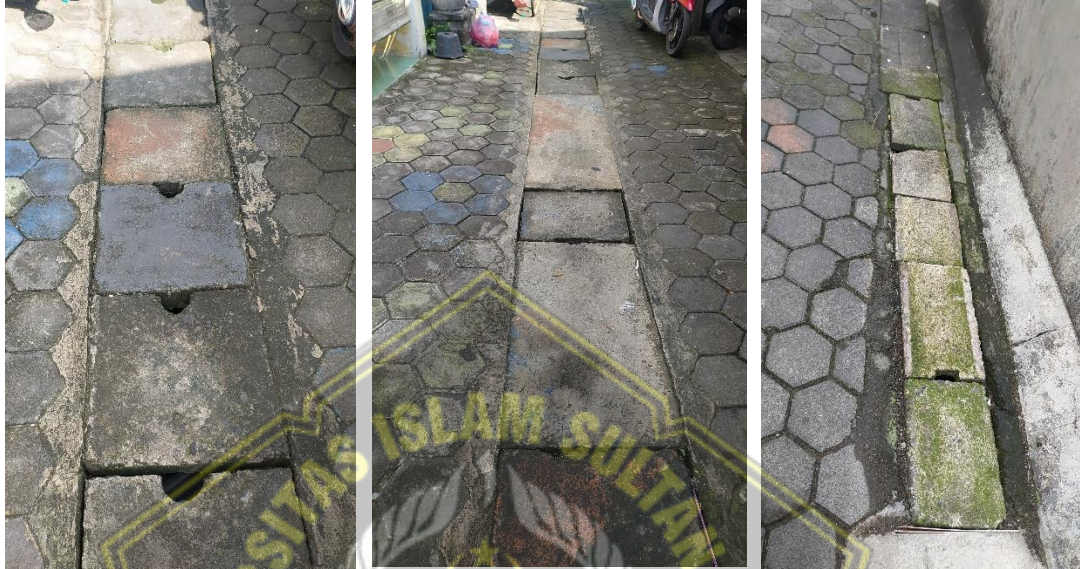
Gambar 4.12 Kondisi Drainase Kampung Tematik Bagilo
