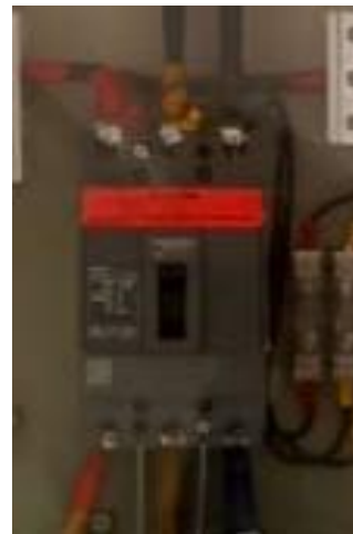
Gambar 4. 4 MCCB pada SDP Lantai 3
