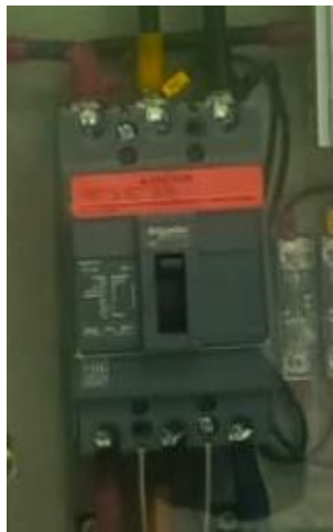
Gambar 4. 5 MCCB pada SDP Lantai 2
