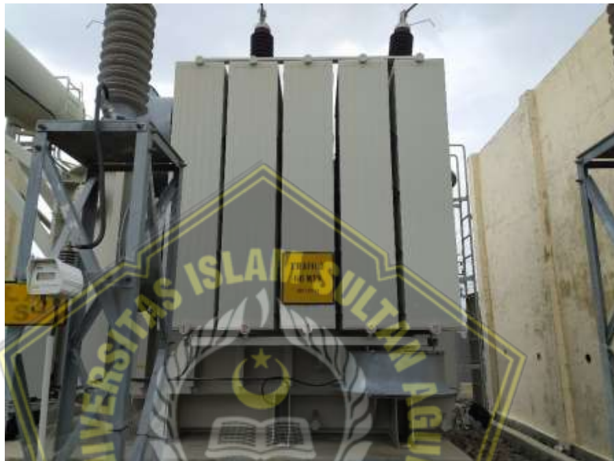
Gambar 2. 9 Trafo daya GI 150/20 kV Brebes.
