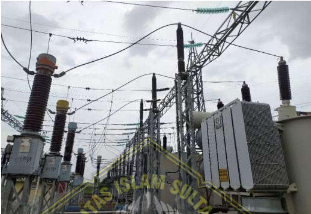
Gambar 2. 2 Lightning Arrester pada GI 150 kV Brebes.
