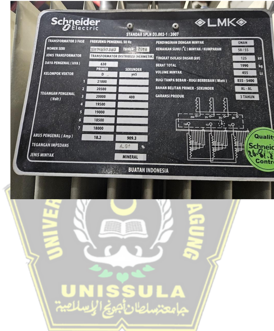
Gambar 2.17 Gambar Nameplate Trafo UGB
