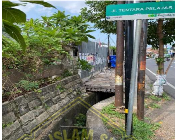
Gambar 4.1 Kondisi Eksisting Drainase (Sumber: Dokumentasi Pribadi)
