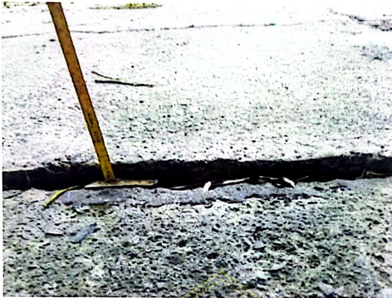
Gambar 4.12. Penurunan atau patahan ( Settlement or Faulting )
