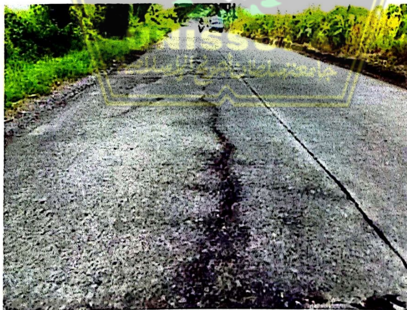
Gambar 4.7. Retak memanjang ( Longitudinal )
