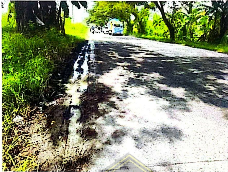
Gambar 4.6. Pinggiran Jalan Turun Vertikal ( Lane / Shoulder Dropp Off )
