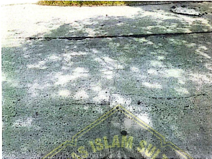
Gambar 4.5. Retak Sambung ( Joint Reflex Cracking ) (Sumber : Dokumentasi Penulis, 2025)
