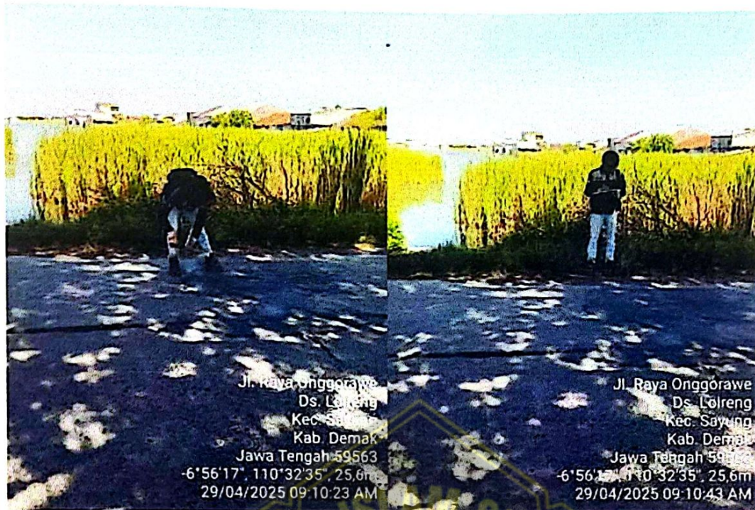
Gambar 4.21. Proses Pengukuran Dan Pendataan Kerusakan Jalan
