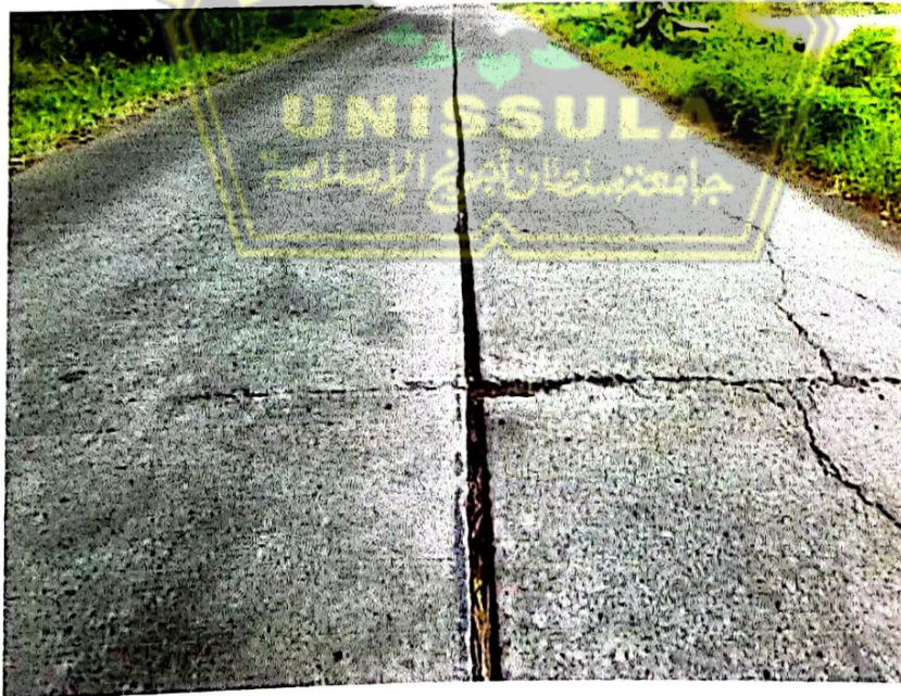
Gambar 4.19. Kerusakan Sambungan ( Joint Spalling / Joint Failure ) (Sumber : Dokumentasi Penulis, 2025)
