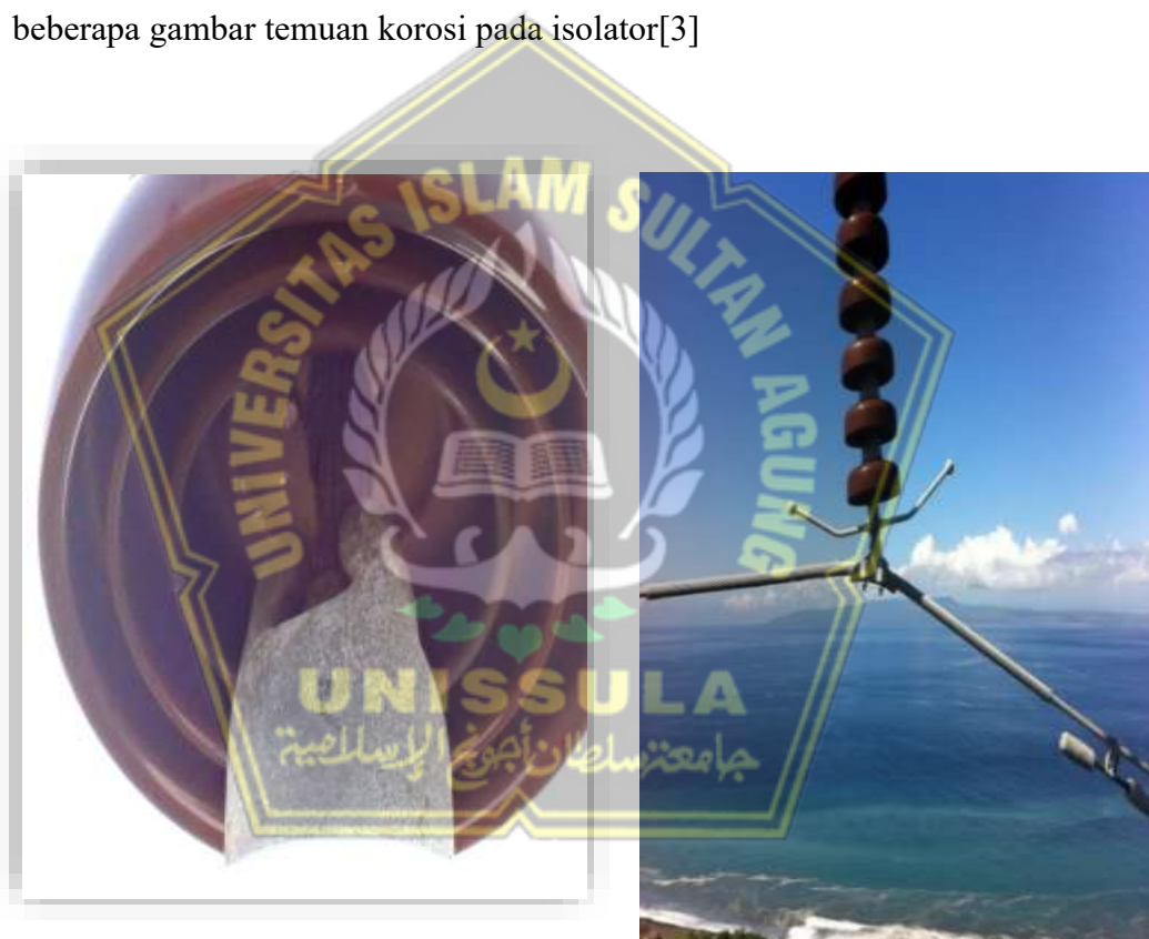
Gambar 2 7 Kondisi Korosi Isolator Didaerah sekitar Pantai[2]
