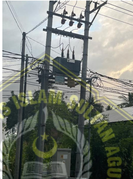
Gambar 2.2 Gardu Trafo Tiang Penyulang Anjani
