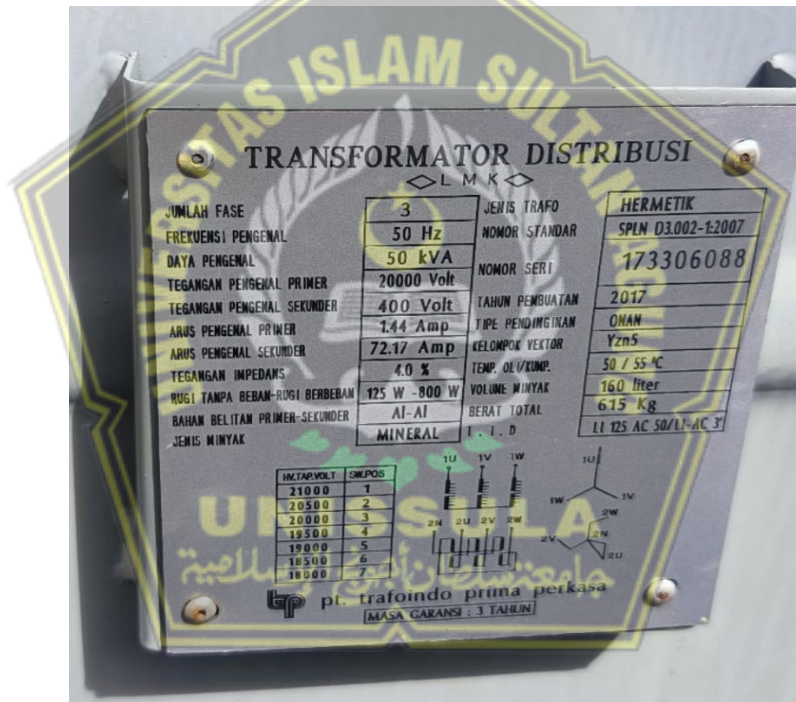
Gambar 3.1 Name Plate Trafo PNIAI007 Merek Trafindo (PT. PLN (Persero) ULP Enarotali, 2025)
