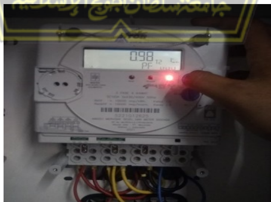
Gambar 4.20 kWh Meter Setelah Penormalan (Sumber: Dokumentasi Pribadi)
