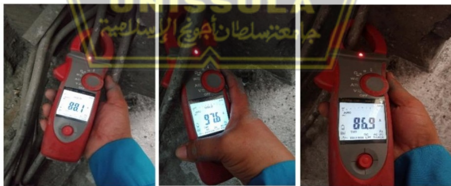
Gambar 4.12 Pengukuran Arus Sebelum Penormalan Menggunakan Tang Ampere (Dokumentasi Pribadi)
