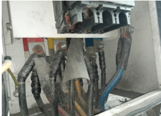
Gambar 4. 11 Dilakukan Sambung Langsung Tanpa Melalui kWh Meter pada CV Sumber Dingin (Sumber: Dokumentasi Pribadi)
