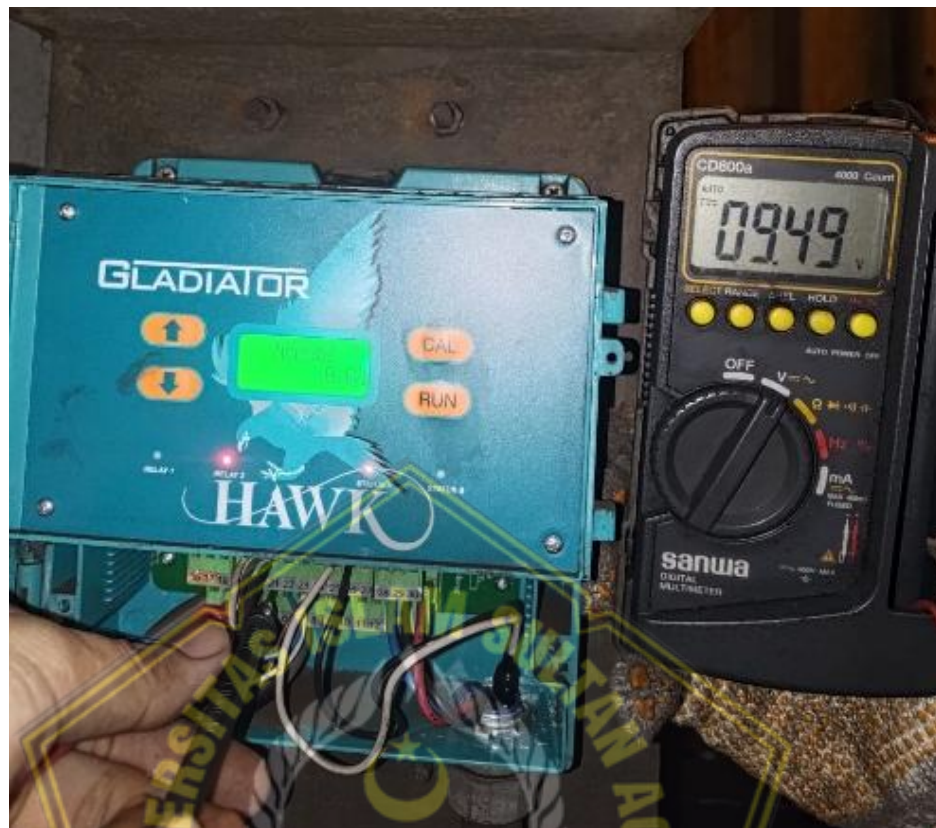
Gambar 4. 7. Hasil Pengukuran Tegangan Receiver Kondisi Chute Penuh
