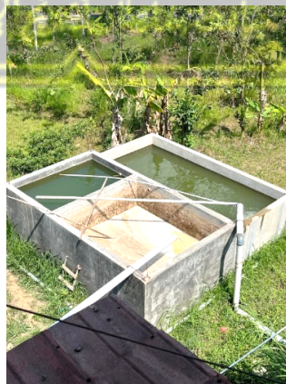
Gambar 1. 1 Instalasi Pengolahan Air Limbah pada UKM Tahuiku Salatiga
