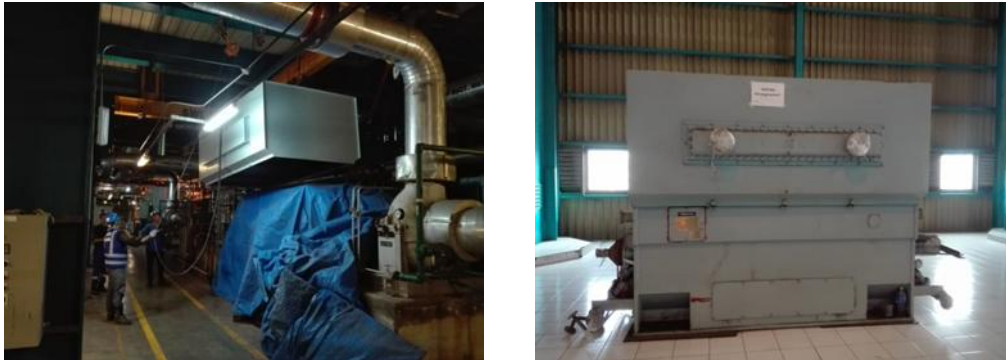
Gambar 2. 5. BFP PLTU Tanjung Jati B
