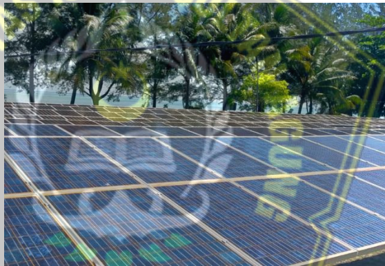
Gambar 2.2 Panel Surya Pulau Derawan
