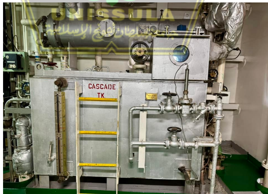
Gambar 2.2 Tangki air pengumpan ketel (cascade tank)
