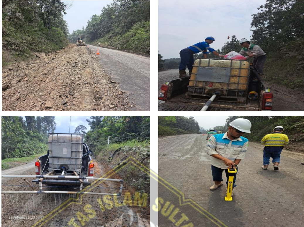
Gambar 3.8 Proses Penerapan Geopoll di Jalan Hauling
