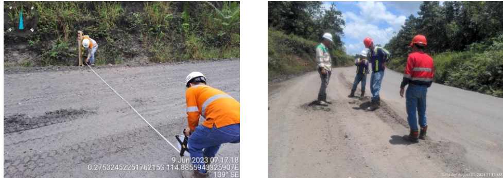
Gambar 3.4. Penilaian Kondisi Kerusakan Jalan Hauling
