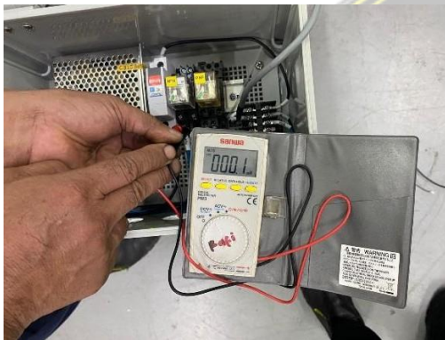
Gambar 4. 12 Pengukuran Tegangan Photo Sensor Tidak Ada Barang
