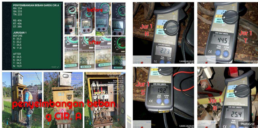
Gambar 4. 9 Penyeimbangan Gardu CIRA Gambar 4. 10 Pengukuran Gardu CIRA
