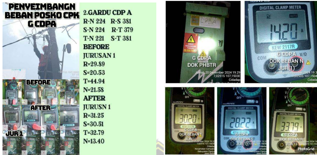
Gambar 4. 5 Penyeimbangan Gardu CDPA Gambar 4. 6 Pengukuran Gardu CDPA
