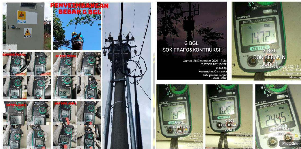
Gambar 4. 1 Penyeimbangan Gardu BGL Gambar 4. 2 Pengukuran gardu BGL
