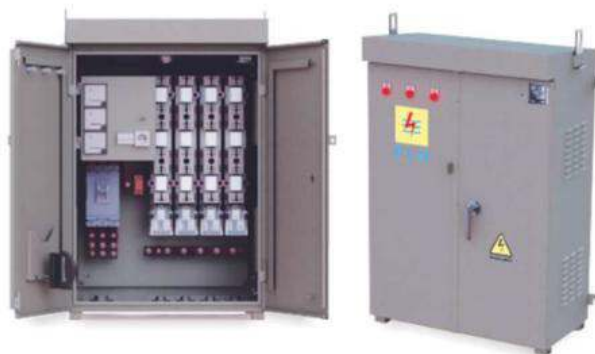
Gambar 2. 7 Peralatan Hubung Bagi Tegangan Rendah
