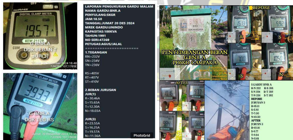
Gambar 4. 3 Penyeimbangan Gardu BNRA Gambar 4. 4 Pengukuran Gardu BNRA
