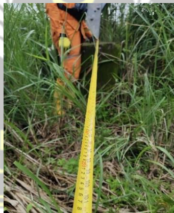
Gambar 4. 4 Mengukur jarak kaki tower dengan ground rod yang akan ditanam
