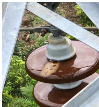
Gambar 2. 12 Flashover pada Isolator [20]
