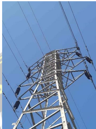
Gambar 2. 3 SUTT 70kV Kadipaten-Arjawinangun
