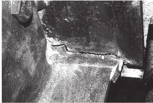
Gambar 2.8. Kegagalan Pada Transisi Pengelasan Akibat Gempa Northridge 1994
