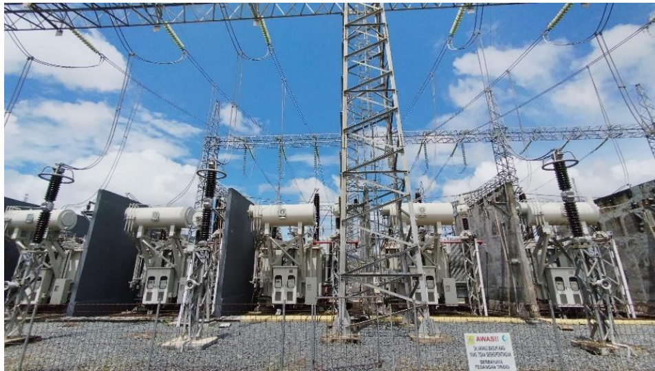
Gambar 2. 4. IBT 1 dan IBT 2 GITET 275 kV Bengkayang
