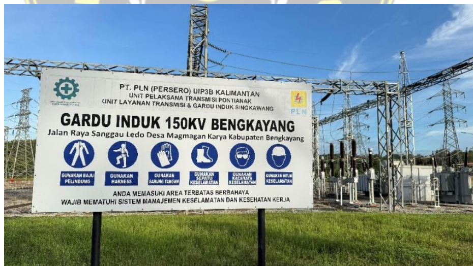
Gambar 2. 5. Gardu Induk 150 kV Bengkayang
