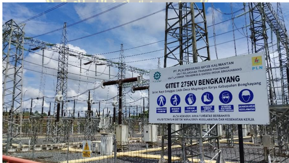
Gambar 2. 3. Gardu Induk Tegangan Ekstra Tinggi 275 kV
