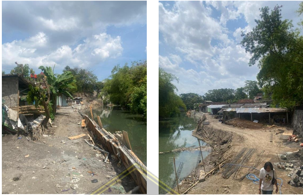
Gambar IV. 8 Kondisi Jalan Permukiman Sempadan Sungai
