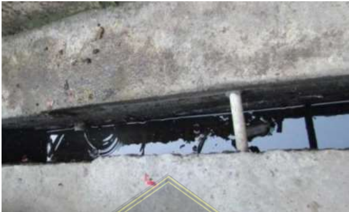
Gambar 4. 7 Kondisi Drainase Desa Morodemak
