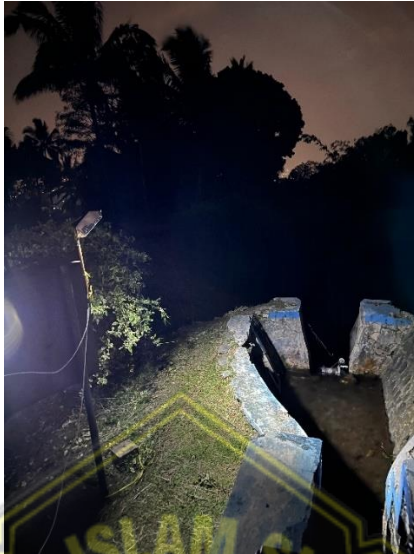
Gambar 5. 11 Lampu penerangan pada dekat turbin
