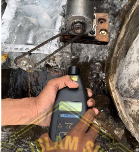
Gambar 5. 6 Pengukuran RPM generator yang tersambung pada beban dan kapasitor
