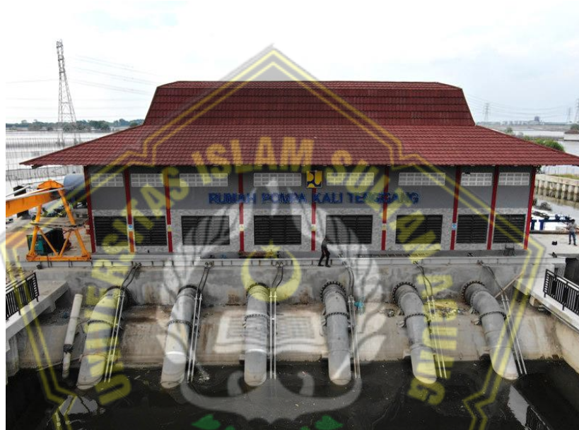
Gambar 3.3 Rumah Pompa Tenggang Sumber : Dok. BBWS Pemali Juana, 2020
