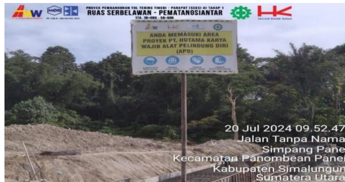
Gambar 2. 3. Rambu Peringat Penggunaan APD (Sumber Proyek Jalan Tol Tebing Tinggi - Parapat (Tahap I) Ruas Serbelawan - Pematangsiantar Seksi 4)
