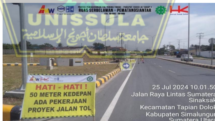
Gambar 2. 5. Rambu Tanda Bahaya (Sumber Proyek Jalan Tol Tebing Tinggi - Parapat (Tahap I) Ruas Serbelawan - Pematangsiantar Seksi)
