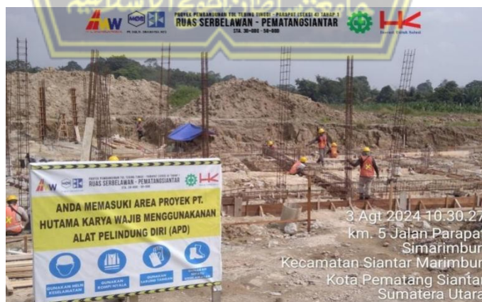
Gambar 2. 2. Rambu Peringat Penggunaan APD (Sumber Proyek Jalan Tol Tebing Tinggi - Parapat (Tahap I) Ruas Serbelawan - Pematangsiantar Seksi 4)
