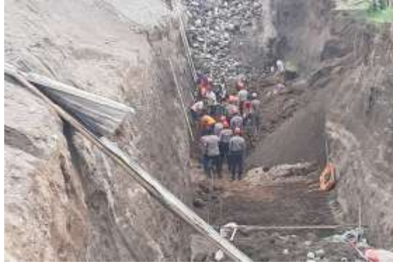
Gambar 2.7. Tanah longsor/runtuhnya dinding samping
