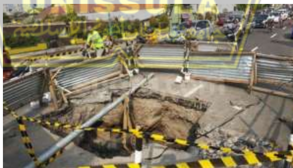
Gambar 2.1. Pekerja terjatuh pada lubang galian (Sumber : SuaraJogja.id diakses pada 26 September 2024)
