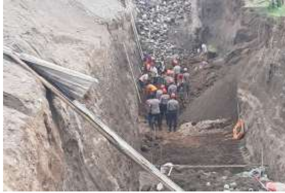
Gambar 2.7. Tanah longsor/runtuhnya dinding samping
