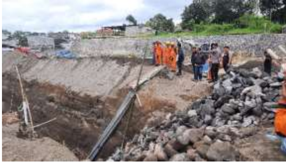
Gambar 2.2. Pekerja tertimpa material galian (Sumber : rri.co.id diakses pada 26 September 2024)
