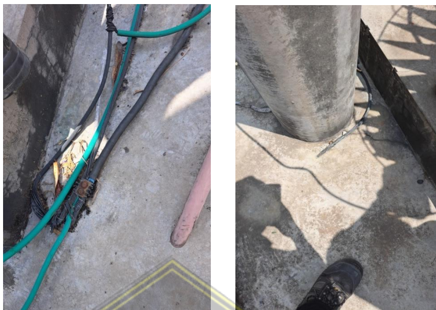
gambar 4. 5 kondisi terkini sistem pentanahan trafo 630kVA milik PT GS Ungaran
