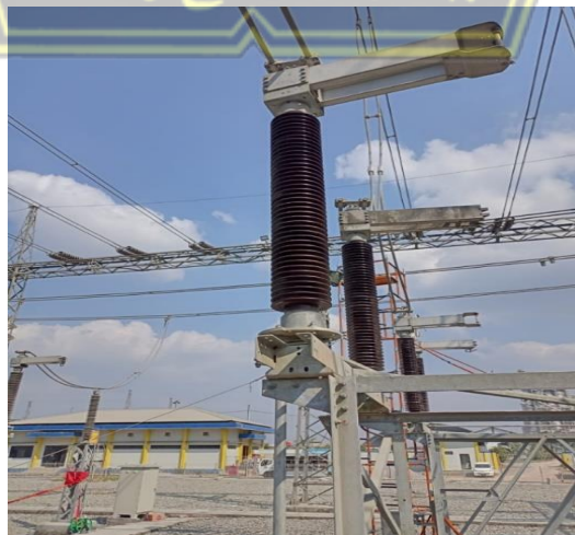
Gambar 2.2 Foto aplikasi isolator tipe C pada PMS GI 150 kV Semen Indonesia
