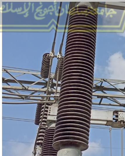
Gambar 4.10 Isolator bay Blora 1 busbar 1 sebelum pemeliharaan
