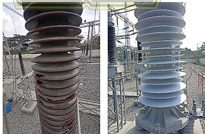
Gambar 3.4 Isolator kondisi setelah pemeliharaan
