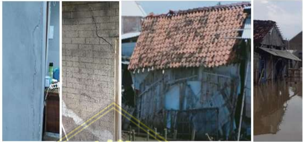
Gambar 4.4 Kerusakan Fisik Komponen Struktur
