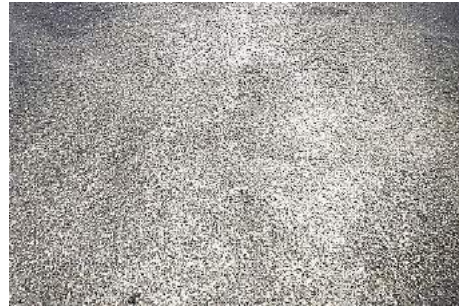
Gambar 4. 35 Kerusakan Pengausan 0+970-1+020 (Sumber: Hasil Survey 16-10-2023)
