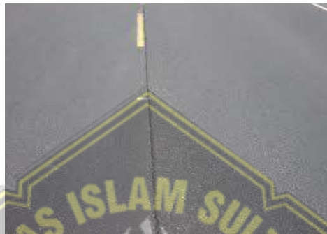
Gambar 2. 6 Retak Sambungan Jalan ( Lane Joint Cracks )
