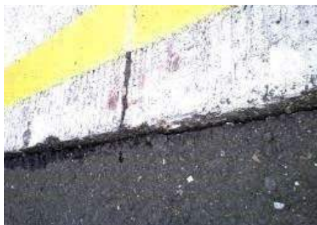
Gambar 2. 5 Retak Sambungan Bahu dan Perkerasan ( Edge Joint Cracks )
