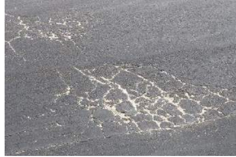
Gambar 4. 31 Kerusakan Retak Kulit Buaya 2+020-2+070 (Sumber: Hasil Survey 16-10-2023)
