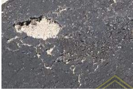
Gambar 4. 22 Kerusakan Lubang STA 1+620-1+670 (Sumber: Hasil Survey 16-10-2023)
