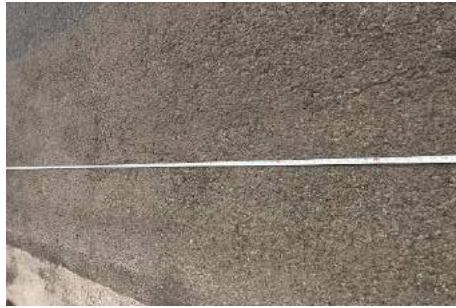
Gambar 4. 12 Pengukuran Dimensi Kerusakan Pengausan (Sumber: Hasil Survey 16-10-2023)
