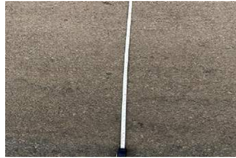
Gambar 4. 13 Pengukuran Dimensi Kerusakan Pengausan (Sumber: Hasil Survey 16-10-2023)
