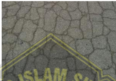
Gambar 2.3 Retak Kulit Buaya ( Alligator Cracks )
