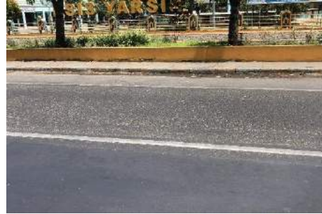
Gambar 4. 23 Kerusakan Pengausan STA 1+620-1+670 (Sumber: Hasil Survey 16-10-2023)
