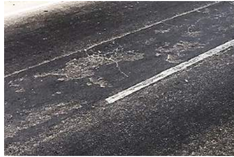
Gambar 4. 26 Kerusakan Pelepasan Lapisan STA 1+820- 1+8700 (Sumber: Hasil Survey 16-10-2023)
