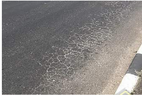
Gambar 4. 34 Kerusakan Retak Kulit Buaya 0+970-1+020 (Sumber: Hasil Survey 16-10-2023)
