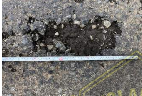
Gambar 4. 8 Pengukuran Dimensi Kerusakan Lubang (Sumber: Hasil Survey 16-10-2023)
