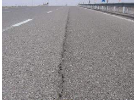
Gambar 2. 7 Retak Sambungan Pelebaran Jalan ( Widening Cracks )
