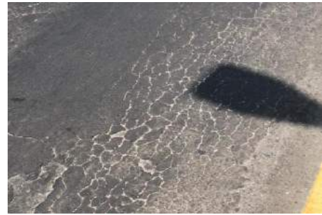
Gambar 4. 39 Kerusakan Retak Kulit Buaya 1+670-1+720 (Sumber: Hasil Survey 16-10-2023)
