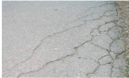
Gambar 2. 4 Retak Pinggir ( Edge Cracks )
