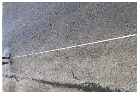
Gambar 4. 16 Pengukuran Dimensi Kerusakan Retak Rambut (Sumber: Hasil Survey 16-10-2023)
