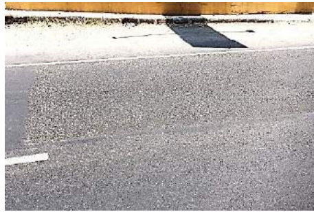
Gambar 4. 38 Kerusakan Pengausan 1+670-1+720 (Sumber: Hasil Survey 16-10-2023)
