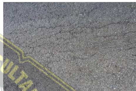
Gambar 4. 41 Kerusakan Retak Rambut 1+670-1+720 (Sumber: Hasil Survey 16-10-2023)
