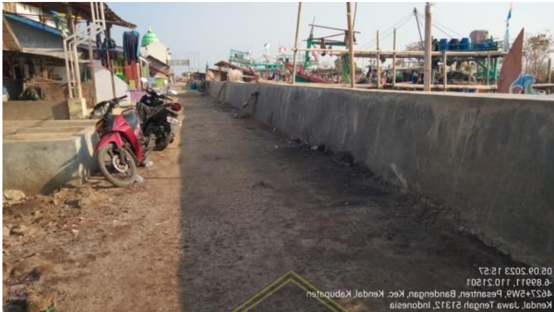
Gambar 3.12 Drainase tidak Berfungsi
