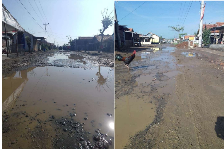
Gambar 2.2. Kerusakan fasilitas jalan akibat banjir di pesisir pantai Blendung di Kab.Pemalang (Dok Pribadi,2020)
