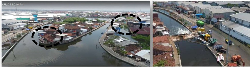
Gambar 5.10 Pembuatan Kisdam sementara Sungai Sringin (Pesisir Semarang) sebagai alternatif karena tidak optimalnya fungsi bangunan pengendali banjir yang ada
