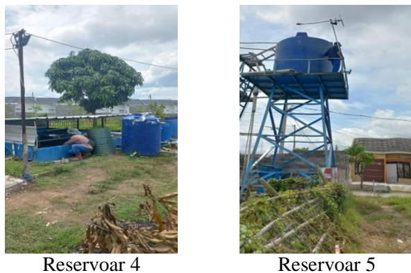
Gambar 4.44 Pengujian Sensor reservoir 4 dan reservoir 5 di lapangan
