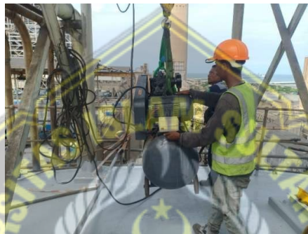
Gambar 4.3 Pekerja tidak mengenakan APD lengkap
