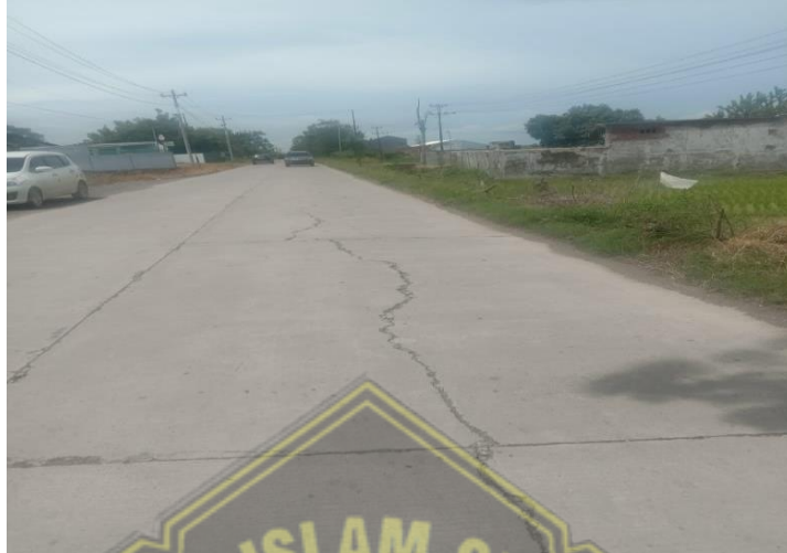
Gambar 1.1 Retak Memanjang Jalan
