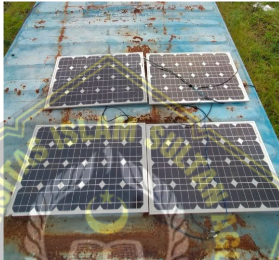
Gambar 3. 12 Panel surya yang disusun secara seri-paralel.
