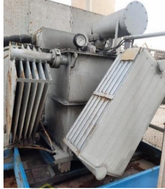
Gambar 2.11 Transformer-Rectifier Unit pada ESP
