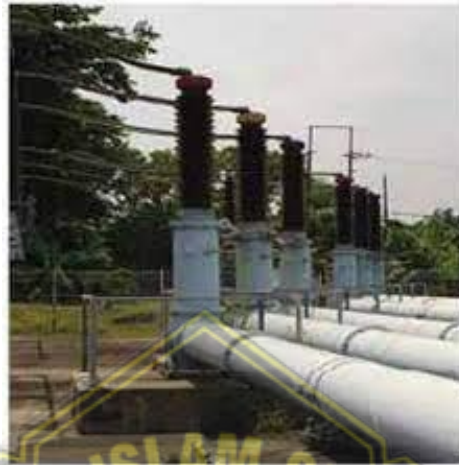
Gambar 2.4 Saluran Listrik Isolasi Gas ((PT. PLN (Persero), 2014c))
