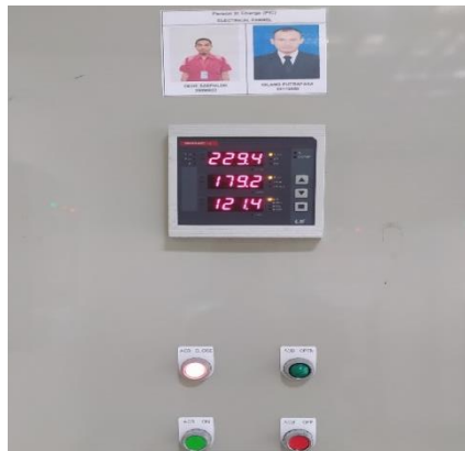
Gambar 2.7. Power Meter pada panel MDP
