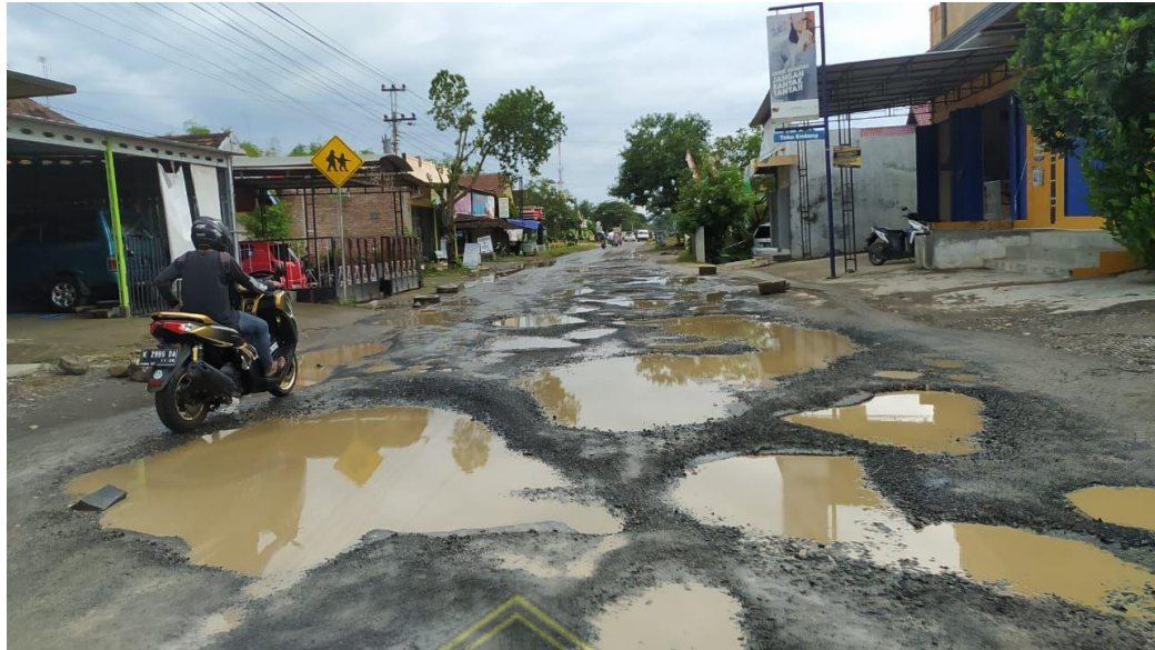
Gambar 4.2 Kondisi ruas jalan Pati – Gabus rusak berat.
