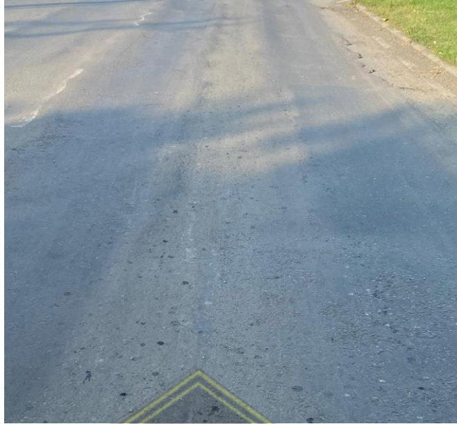
Gambar 2.2 Distorsi pada jalan Sumber : Survey Lapangan, 2022.
