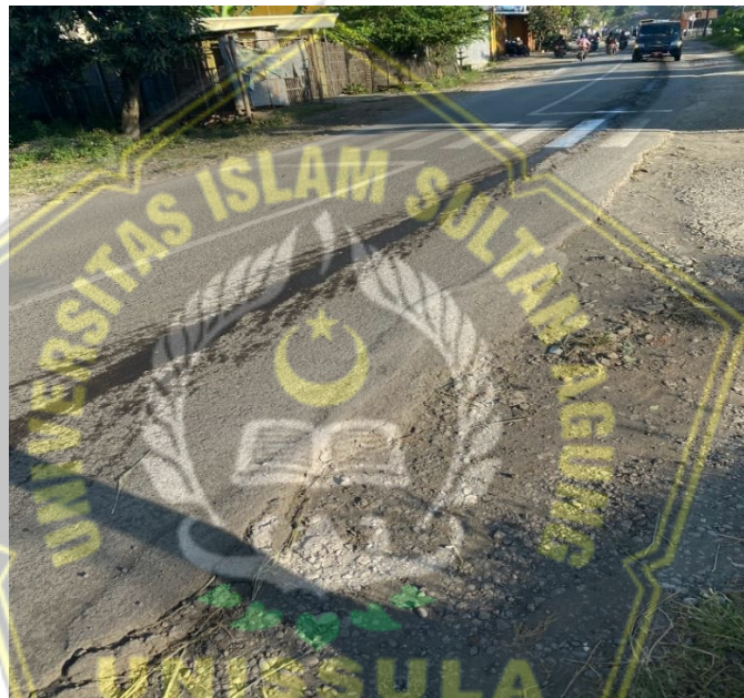
Gambar 2.4 Kegemukan pada jalan Sumber : Survey Lapangan, 2022.
