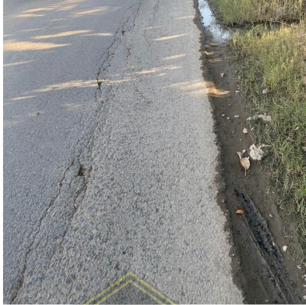
Gambar 2.1 Retak pada jalan
