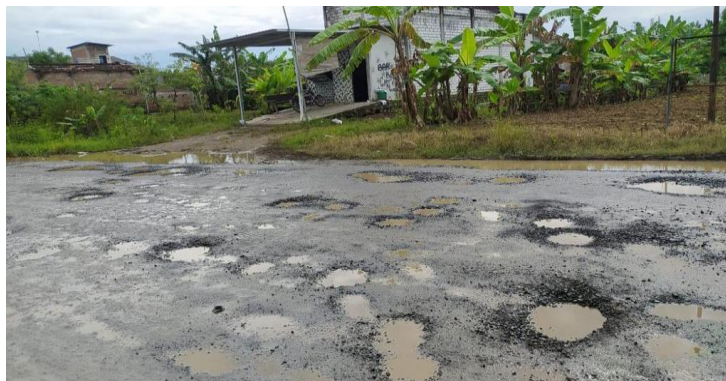
Gambar 2.3 Lubang pada jalan Sumber : Survey Lapangan, 2022.
