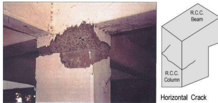
Gambar 2.2 Retak Horizontal ( Horizontal Crack )
