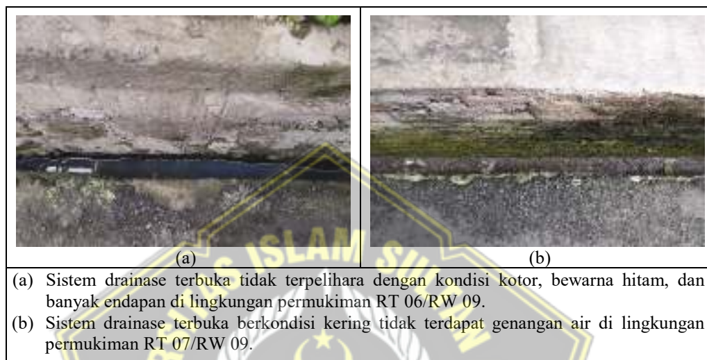
Gambar 4. 18. Tidak Terpeliharanya Drainase Lingkungan Permukiman Terdampak Rob di Wilayah RW 09
