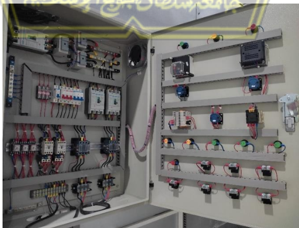
Gambar 4.2 Panel Kontrol Tampak Dalam
