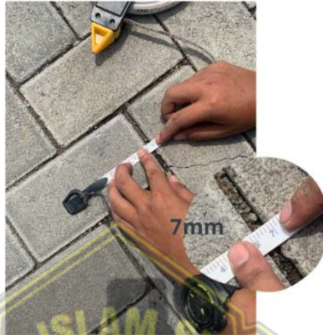
Gambar 4.20. Jarak antar paving block akibat lendutan di titik 1 Sumber: Pengamatan lapangan
