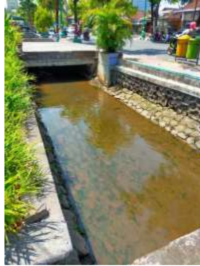
Gambar 4.36 Kondisi Saluran di Jl. Pemuda
