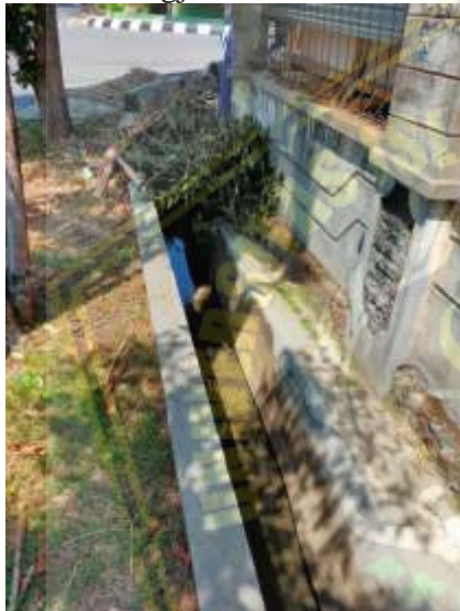
Gambar 4.7 Kondisi Saluran di Jl. Mangunsarkoro
