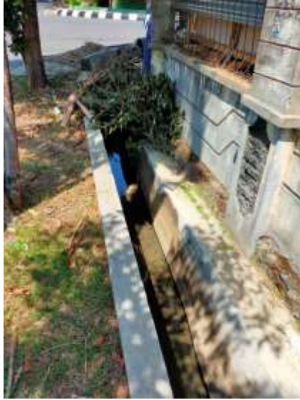
Gambar 4.35 Kondisi Saluran di Jl. Mangunsarkoro
